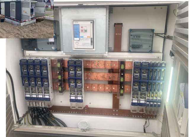
10 kV -> 400 V op locatie
